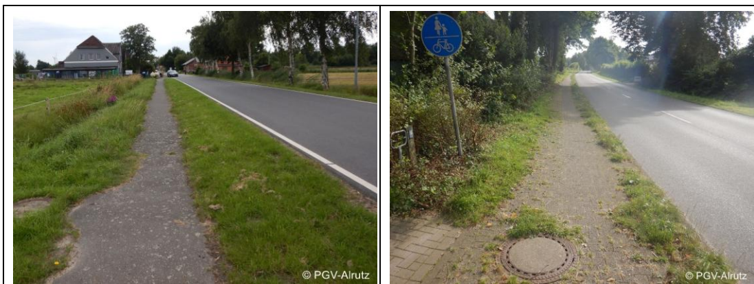
Abb. 4-7: Beispiele für starken Grünbewuchs baulicher Radverkehrsanlagen im Zuge der L 137 in Landscheide (links) sowie im Zuge der L 123 (Hauptstraße) in Rade (rechts)
